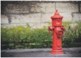
fire hydrant la boca de incendio
