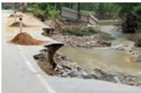
landslide el desprendimiento de tierras
